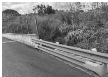
图2 刚性护栏与柔性护栏搭接处未设置过渡区情况实拍图
